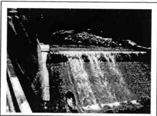
チロル型式と呼ばれる溪流取水工 ↑ （土砂が比較的少ない場所に設置）
