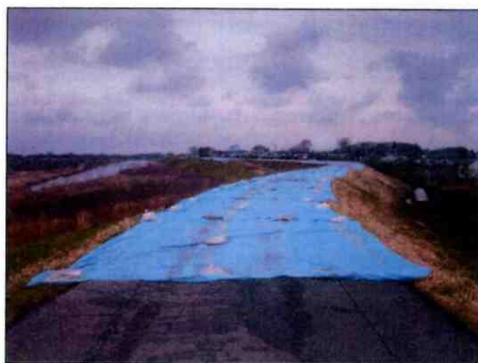
東日本大震災による被災状況〔結城市久保田地区・中地区〕 堤防の天端、法面に縦断方向に亀裂が発生
