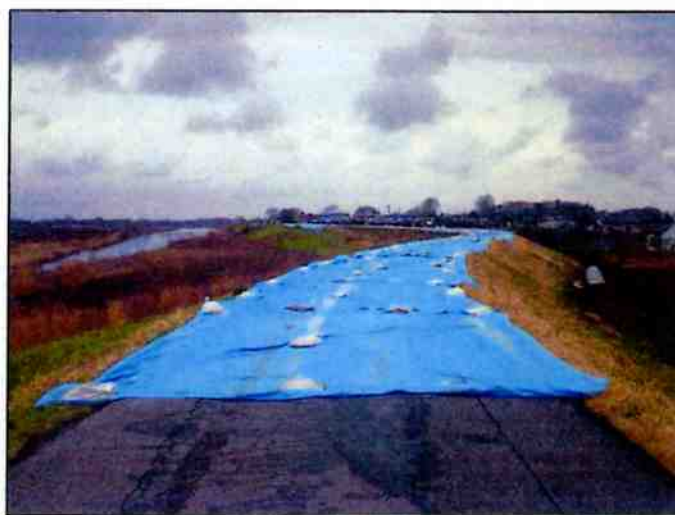
東日本大震災による被災状況 〔結城市久保田地区・中地区〕 堤防の天端、法面に縦断方向に亀裂が発生
